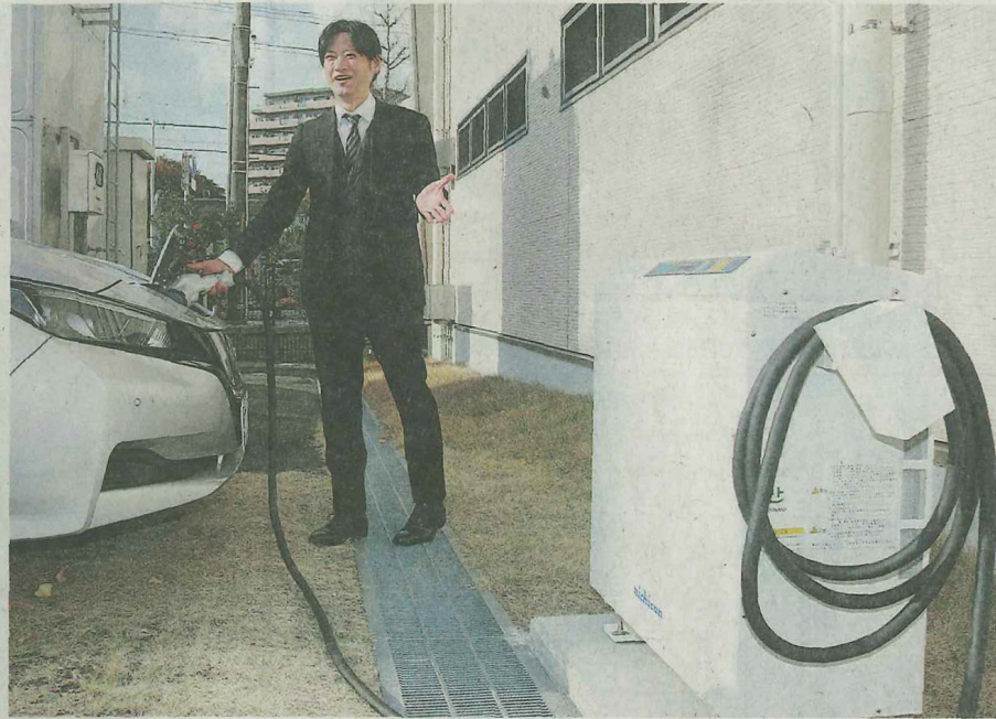
エネジンが導入したV2Hの設備＝浜松市中区で
